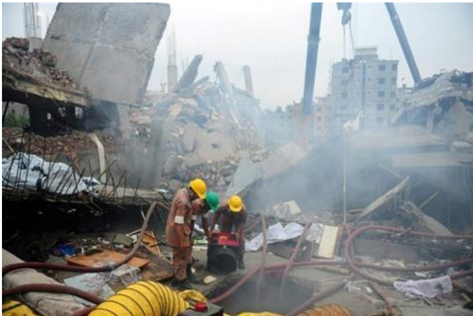
Des pompiers tentent de maîtriser un incendie lors d'opérations de secours après l'effondrement de l'immeuble du Rana Plaza abritant des ateliers textiles, le 29 avril 2013, au Bangladesh. Photo: AFP/VNA/CVN
